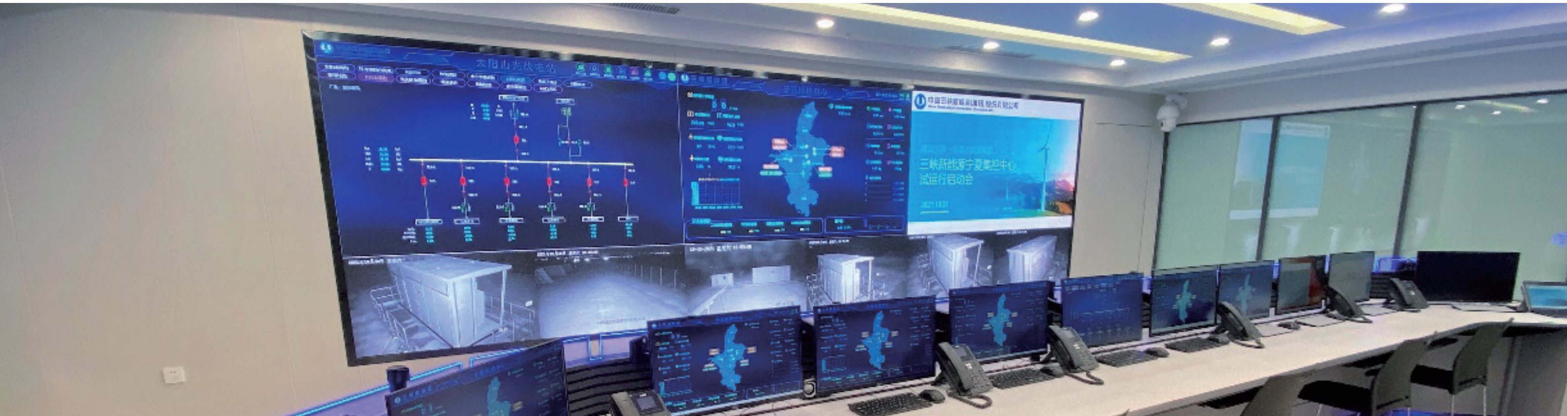
集控中心现场
